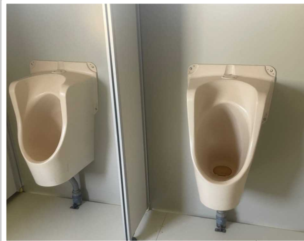
【ソフトボール】(太良町) 仮設トイレ内部
